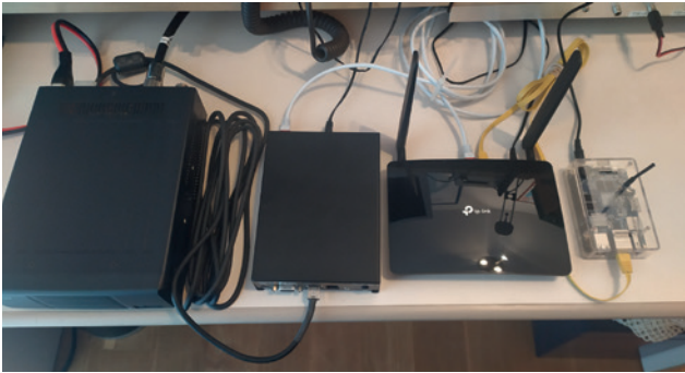
Figura 3. De izquierda a derecha, cuerpo del Icom 7100, RemoteRig, router 4G y microordenador Orange Pi (oran01). Son la mitad "monte" de nuestra instalación
